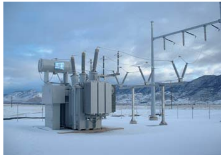
Solar Turbines (EEUU) Transformador de fuerza 75 MVA - 169 kV
