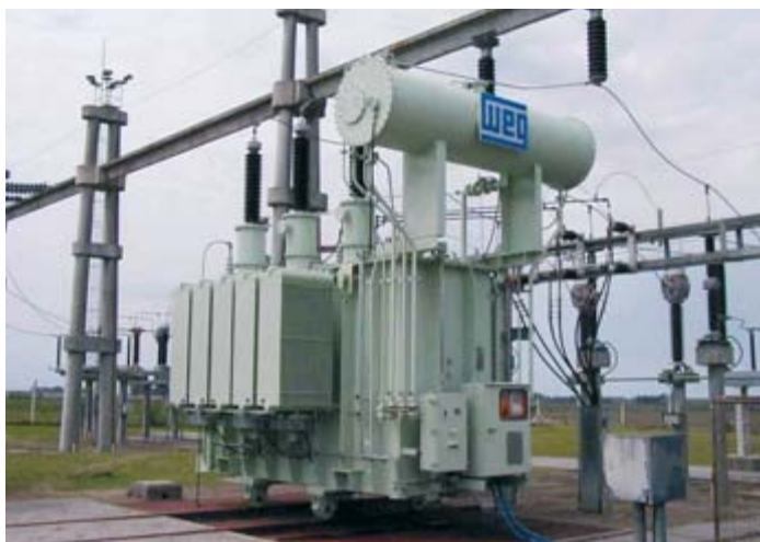
Energía de Entre Ríos S.A. - ENERSA (Argentina) Transformador de fuerza 30 MVA - 145 kV
