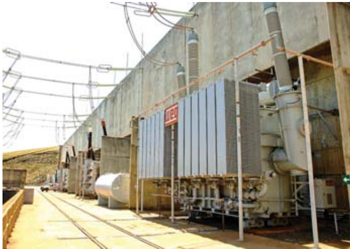
Duke Energy (Brasil) Central Hidroeléctrica - Transformador elevador de usina 200 MVA - 500 kV
