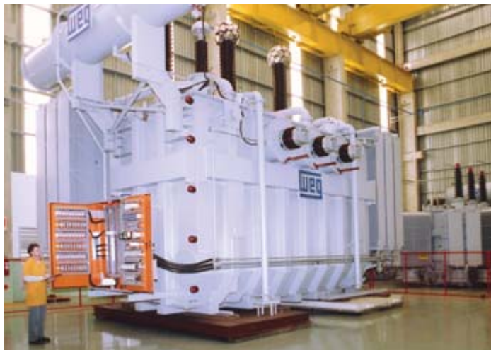
GE Hydro (Brasil) Usina Hidroeléctrica - Transformador GSU 311 MVA - 245 kV (4 unidades)
