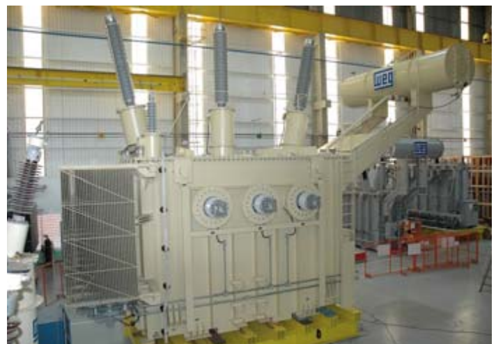
Empresa Eléctrica Colbún Machicura S.A. (Chile) Transformador de fuerza 150 MVA - 245 kV
