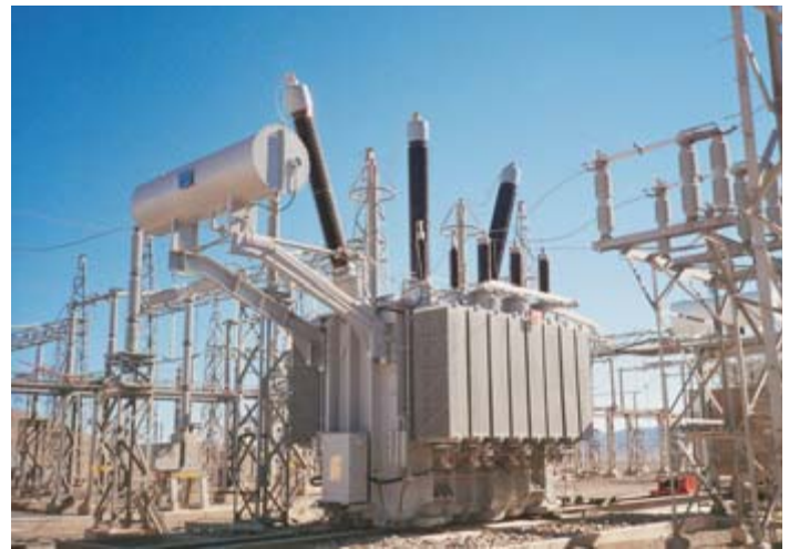
Compañía Minera Zaldivar (Chile) Transformador de fuerza 60 MVA - 245 kV
