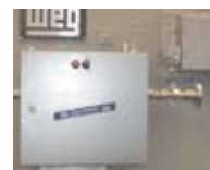
Sistema de presurización para área clasificada
