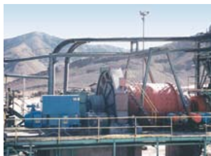
Suministro: MAF450, 920kW (1230HP), 4.160V, 4 polos Aplicación: Molino de bolas
