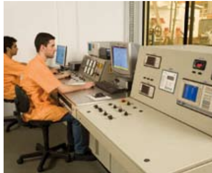
Sala de comando
